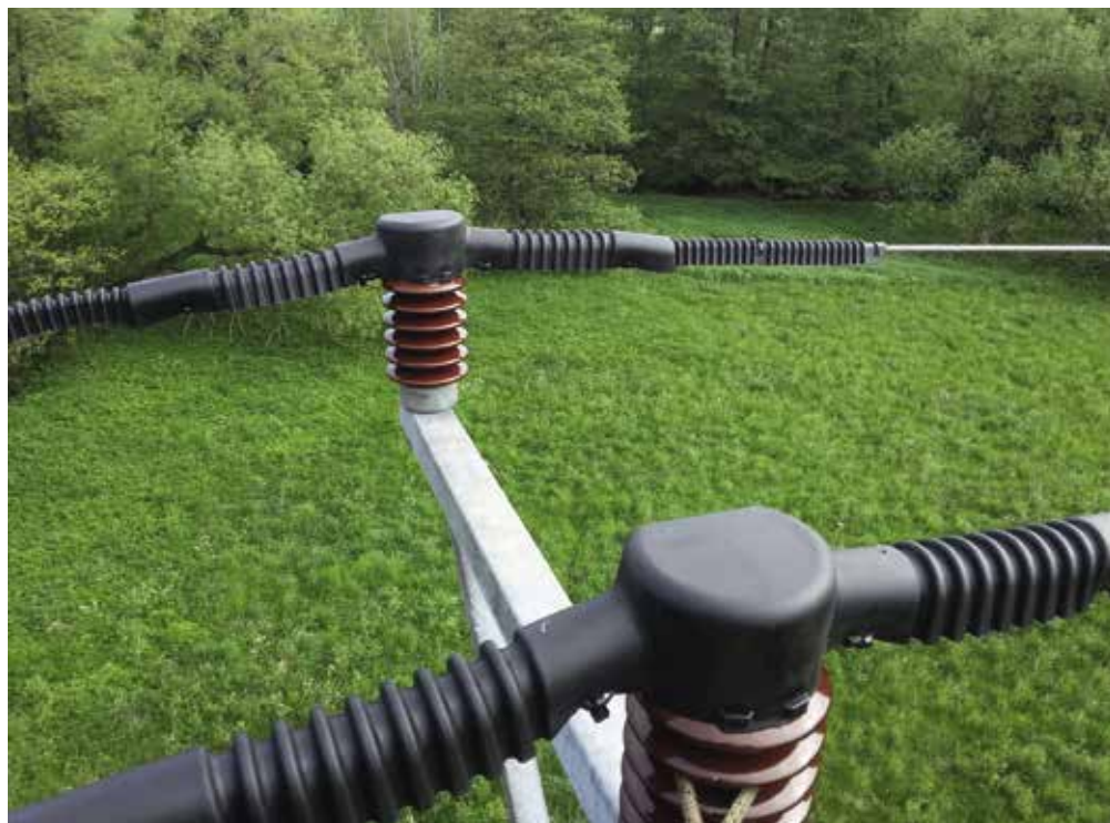
Isolerande plasthölje – en örnsäkring. Foto: Johan Widell, ONE Nordic.
